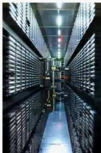
Salle des serveurs sécurisés
